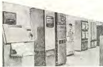
Рис. 1. Информационно-вычислительный центр системы «Цемент-1».
